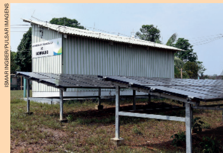
Usina solar instalada na comunidade de Sobrado, no Amazonas, em 2015.
