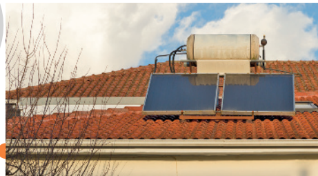
Placas solares no telhado da casa de Daniel.
