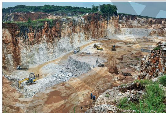
Extração de calcário no município de Almirante Tamandaré, no estado do Paraná, em 2016.
