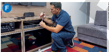
Instalação de televisão a cabo no município de São Paulo, no estado de São Paulo. Foto de 2021.
