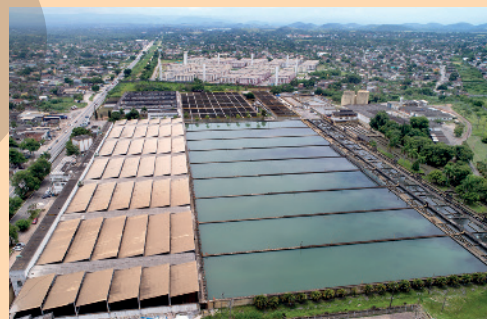
Estação de tratamento de água captada no rio Guandu em Nova Iguaçu, Rio de Janeiro, em 2020.
