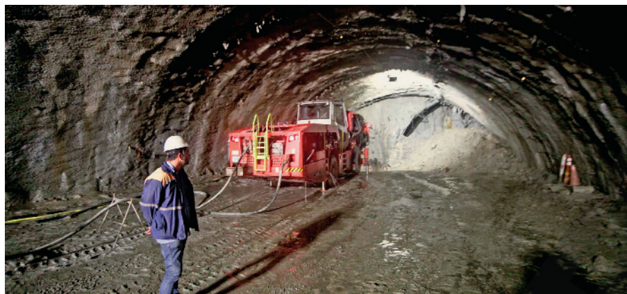
Abertura de túnel no município de Paraibuna, no estado de São Paulo, em 2018.
