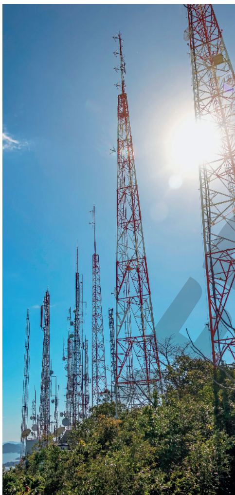
Torres e antenas de telefonia em área rural do município de Florianópolis, no estado de Santa Catarina, em 2017.
