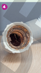
4. Cano com acúmulo de gordura.
