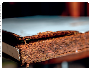
Tampo de móvel danificado.
