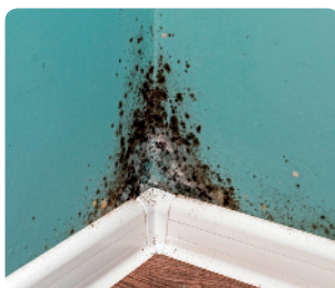
Parede e rodapé embolorados.
