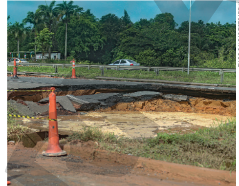
Buraco com deslizamento em estrada em Candeias, BA, 2020.
