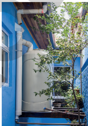
Sistema de captação de água da chuva, em que a água é filtrada e armazenada em um tanque. Município de São Paulo, São Paulo, em 2017.
