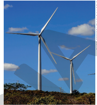
Torres para a produção de energia eólica no município de Caetité, no estado da Bahia, em 2019.
