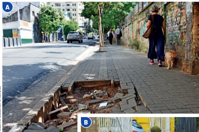
Calçada esburacada em rua do município de São Paulo, no estado de São Paulo, em 2019.
