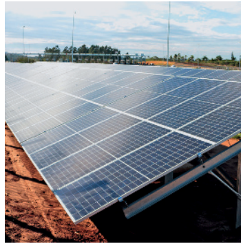
Painéis de captação de energia solar no município de Gravataí, no estado do Rio Grande do Sul, em 2020.
