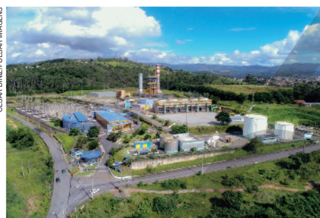
Usina termelétrica a gás natural no município de Ibirité, no estado de Minas Gerais, em 2019.
