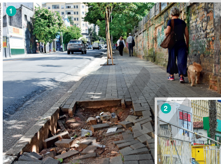
Calçada esburacada em rua do município de São Paulo, no estado de São Paulo, em 2019.
