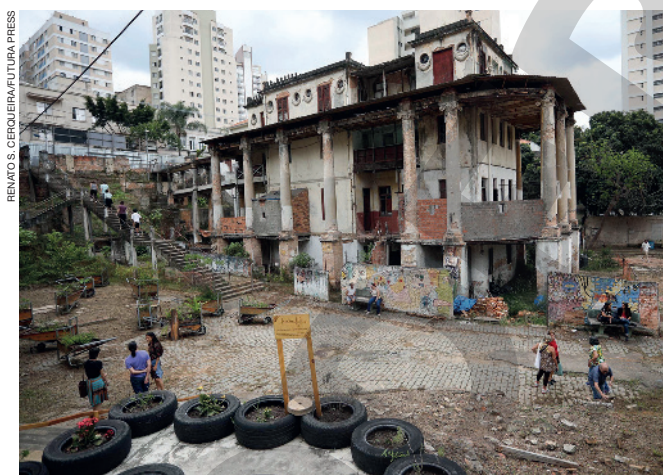
Construção deteriorada no centro da cidade de São Paulo, em 2019.
