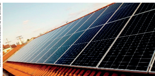
Instalação de sistema com placas solares sobre o telhado de uma escola municipal para a redução dos gastos com o consumo de energia elétrica, em Canoas (RS), 2020.
