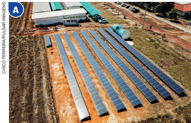
Placas solares no município de Guarantã do Norte, no estado de Mato Grosso, em 2018.
