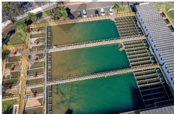
Tanques de decantação em uma estação de tratamento de água. (Presidente Prudente, SP, 2020.)
