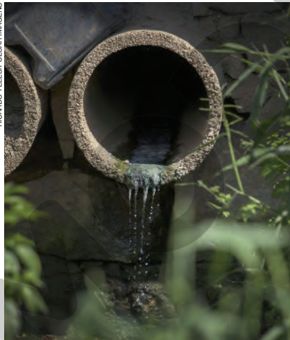
Despejo de esgoto a céu aberto próximo de margem de rio. (Rio Mucuri, Teófilo Otoni, MG, 2018.)
