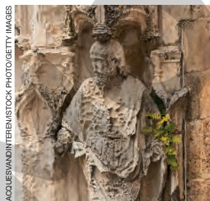
Monumento danificado pela chuva ácida. (Coimbra, Portugal, 2017.)
