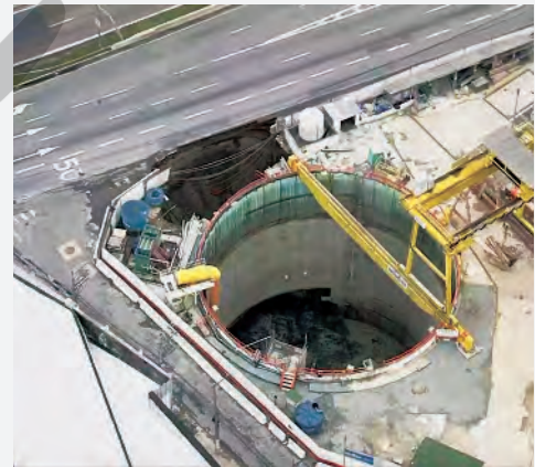
Parte da obra do metrô que passa embaixo da marginal do Rio Tietê desmoronou em São Paulo.
