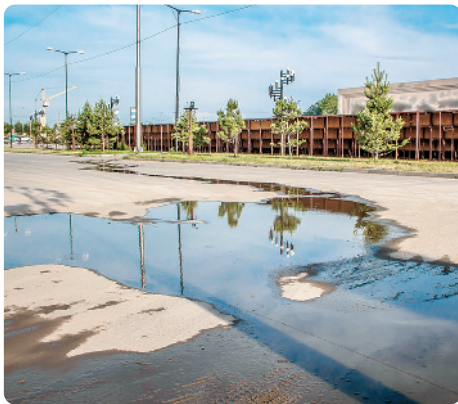
Água da chuva acumulada sobre asfalto.
