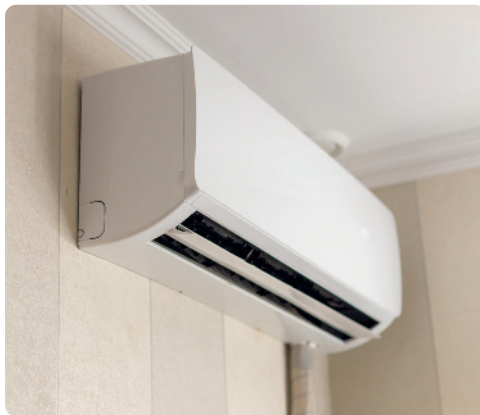
Condicionador de ar.
