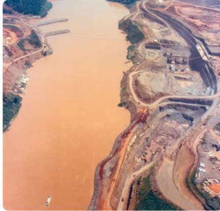
Paisagem mostrando o início da construção da Usina Hidrelétrica de Itaipu, entre os anos de 1975 e 1976.
