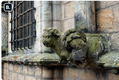
Monumento histórico desgastado pela ação da chuva ácida no Castelo de Stirling, em Stirling, na Escócia, em 2017.
